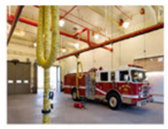
Fire Exhaust 消防排烟
